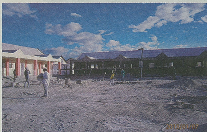
Il cantiere della scuola finanziata con i 623mila euro raccolti in Sardegna
